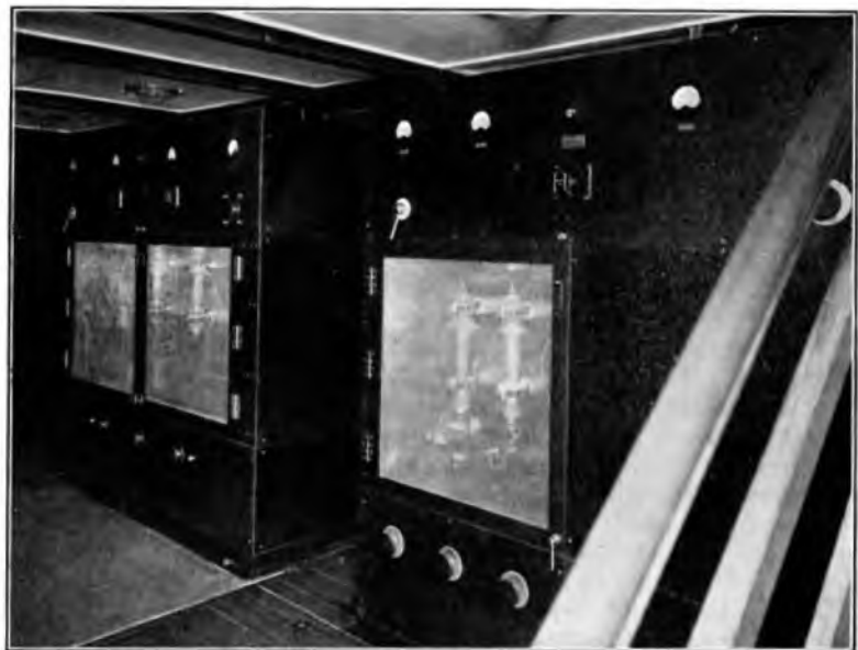
FIG. 8.—HIGH TENSION RECTIFIERS.
