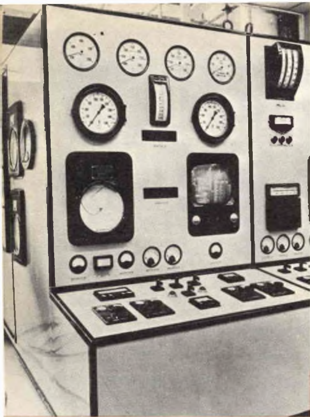
Ecco il quadro di controllo di un apparecchio in funzione in una centrale elettrica inglese; il monitor incorporato permette di osservare a distanza i misuratori del livello dell'acqua.
