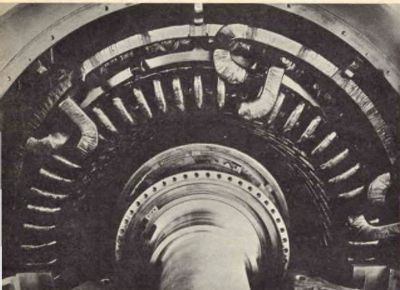
L'alternatore illustrato parzialmente in fotografia, e di cui sono chiaramente visibili le connessioni frontali fra i vari avvolgimenti, fa parte di uno dei quattro gruppi generatori installati nella centrale termica di Chivasso.
