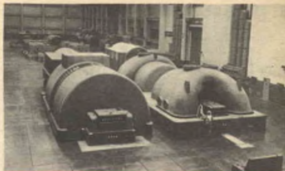
I gruppi turboalternatori raffigurati nella fotografia riprodotta qui sopra sono in grado di generare potenze fino a 360.000 kW (360 milioni di watt!).
