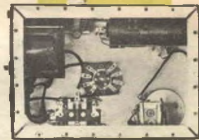
Togliendo il fondo della scatola si vedono i due relè; l'interruttore di linea è al centro.
