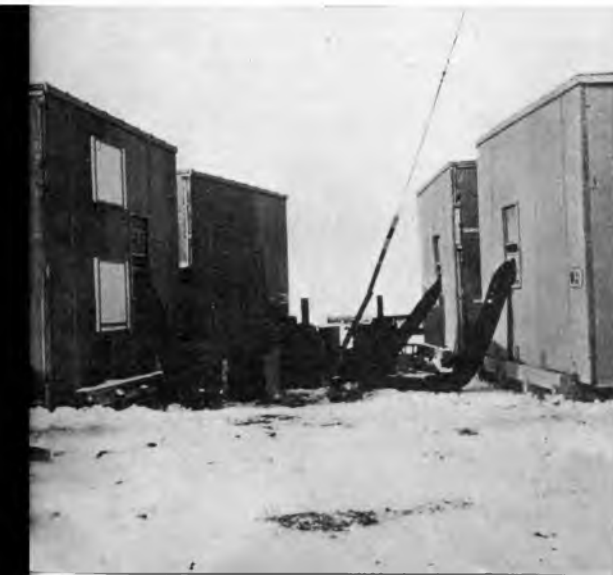
(Sotto). Riscaldatori mobili, « Herman-Nelson », bruciano gasolio o petrolio. Essi riscaldano le unità in costruzione permettendo di lavorare anche con 50 gradi sotto zero.
