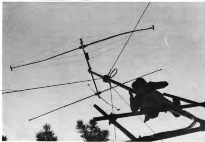
Nella foto vediamo la fase di manutenzione dell'antenna della stazione FECB di S. Marino che trasmette in AM sul canale 11 e in SSB sul canale 15. Operatori: Tunderbooll 27 e Brntolo.
