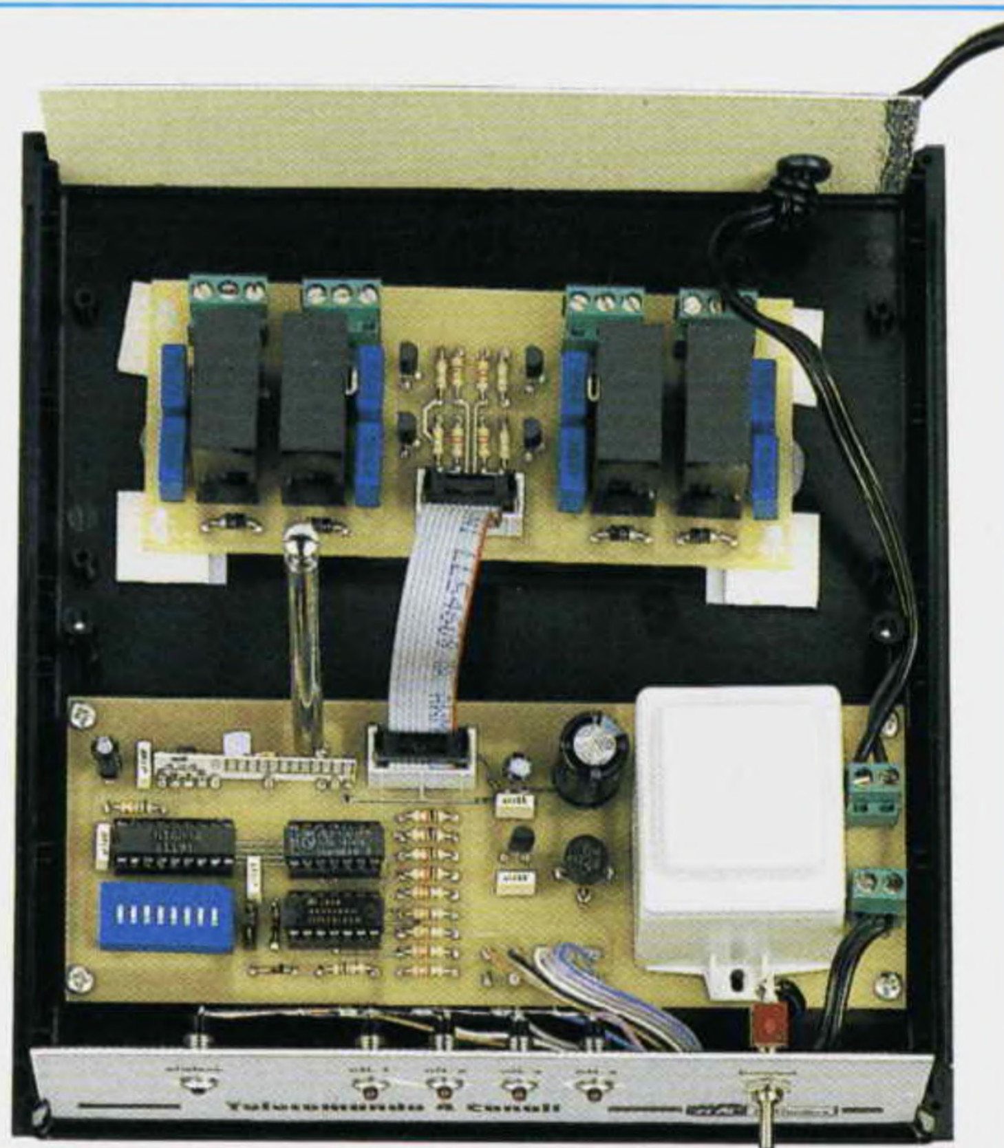
Fig.24 In questa foto potete vedere il circuito LX.1412 di fig.32 che si differenzia dal circuito LX.1411 perchè utilizza 4 relè. Alle morsettiere a 3 poli, poste vicino ad ogni relè, fanno capo i contatti A-B-C. A relè diseccitato risulteranno chiusi i contatti B-A e a relè eccitato risulteranno chiusi i contatti B-C (vedi fig.32).
