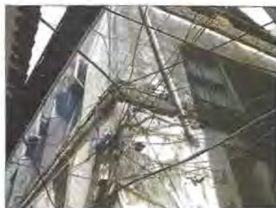
7 - Le réseau électrique de Zanzibar !
