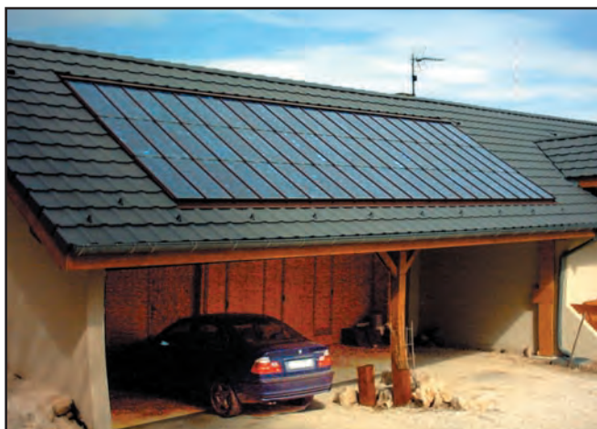
1 - La toiture en panneaux solaires vue de l'extérieur...
