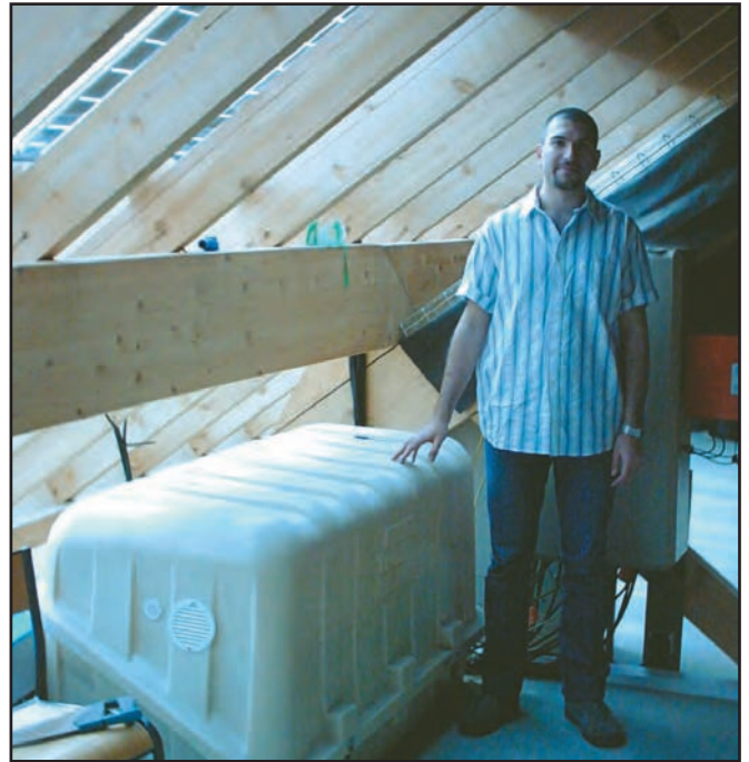
3 - Le propriétaire de l'installation devant le compartiment "batteries".
