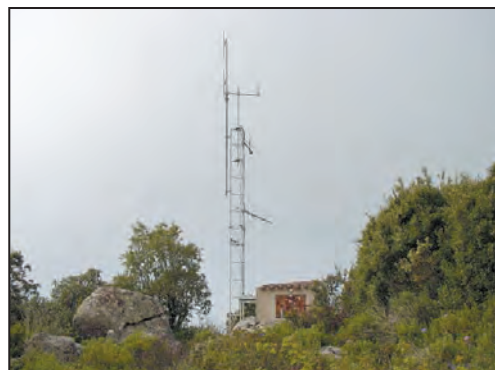
Le pylône de Coti-Chjavari, au nord d'Ajaccio.
