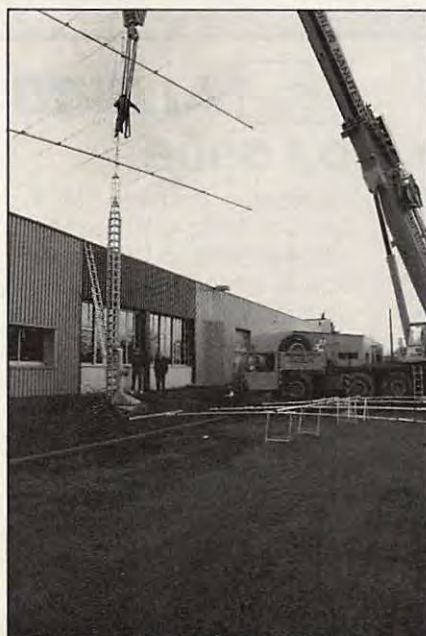
Remplacement d'une des deux 7 éléments par la FB-53 de Fritzel (au sol).
