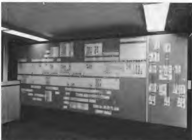
Bild 8. Mosaik-Betriebschaubild in einer Fernwirkleitstelle der Deutschen Bundespost
