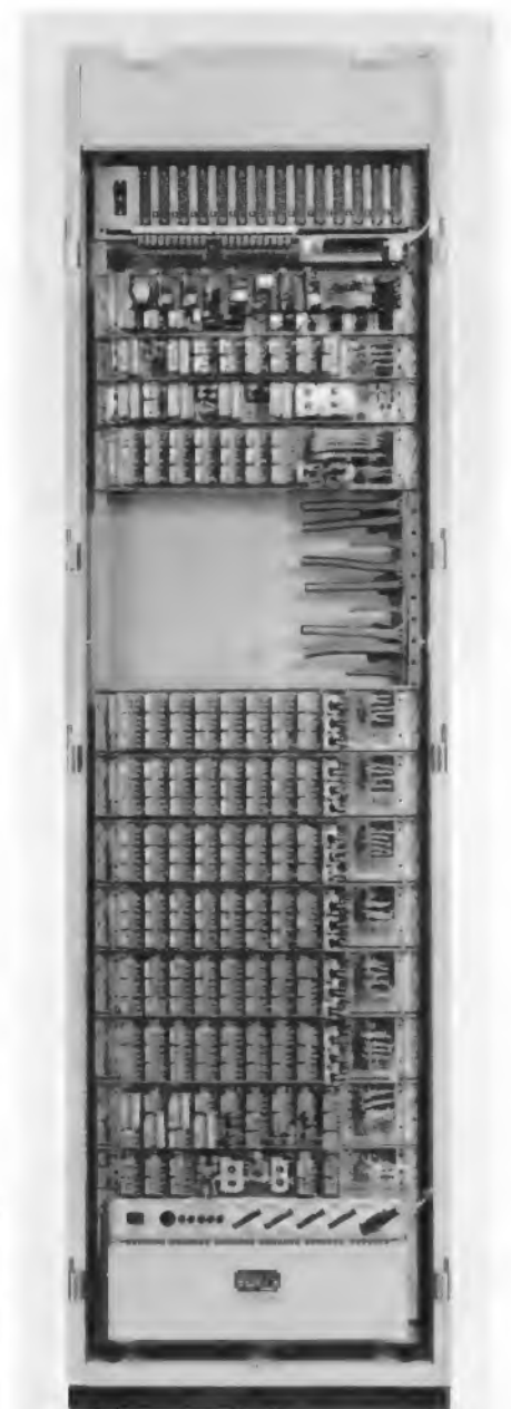
Bild 5. Elektromechanisches Fernwirk-system IST 6
