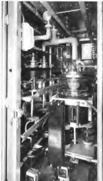
Bild 4. Innenansicht des Modulators mit Katodenfolger- und Leistungs-Endstufe
