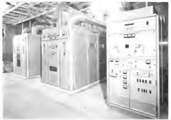
Bild 3. Senderfront des 250-kW-Kurzwellensenders, bestimmt für die Relaisstation Kigali (Marconi). Von links nach rechts: Modulationseinheit, Hf-Einheit, Steuersender
