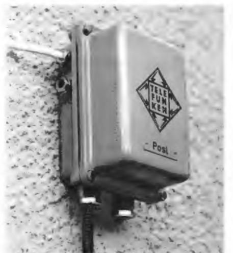
Bild 4. Grundstücksverstärker für fünf Teilnehmer. Von unten kommt die Stichleitung, nach links geht eine Teilnehmerleitung (weiß) ab
