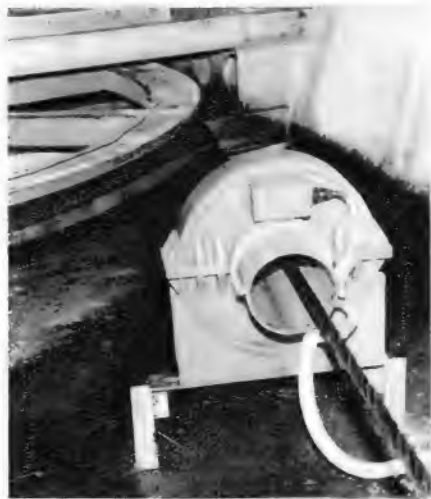
Der Seil-Durchlaufübertrager der elektronischen Seilbahn-Signalanlage am Dachstein. Die Signale für die Kabinen werden induktiv über das Zugseil übertragen, und man kann sich ebenso auch telefonisch mit den Stationen unterhalten
