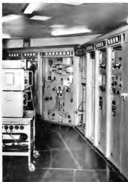
20-kW-UKW-Sender für die Richtfunkstrecken
