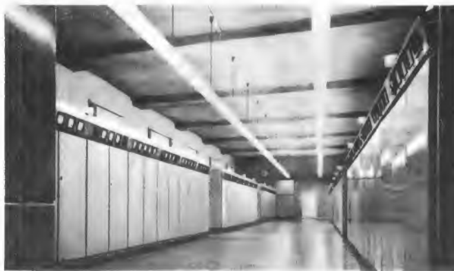
Bild 2. Neuer Sendersaal der Überseefunkstelle Elmshorn mit achtzehn fernbedienbaren 20-kW-Kurzwellensendern
