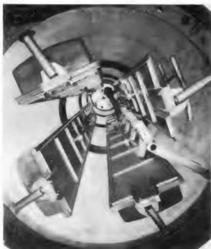
Bild 2. Blick in das Innere eines mit vier Antennenfeldern ausgerüsteten Zylinders. Vom rechten Feld ist die Kappe abgenommen, an der Innenseite sind die Steigsprossen zu erkennen
