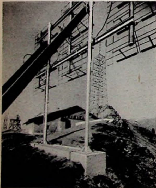
Bild 1. Das Senderhaus auf dem Grünten. Im Vordergrund die Empfangsantenne der Bundespost für die Tonmodulation, im Hintergrund der Antennenturm, allerdings noch ohne Fernseh-Sendeantenne; am linken Bildrand der Empfangsspiegel der Bundespost für die Bildmodulation
