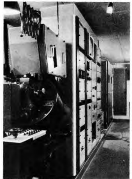
Bild 2. Vorn-Sendeinrichtung für 35-mm-Film mit Mechau - Projektor, dahinter die doppelt vorhandene Impulszentrale und Bildkontrollgeräte in den Studioräumen
