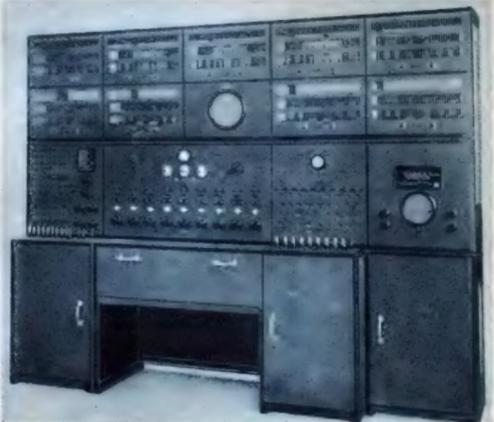
Die Verstärkerzentrale enthält in den beiden oberen Abteilen 9 Verstärker. In der Mitte ist ein Kontroll-Lautsprecher eingebaut. Links darunter befindet sich das Eingangs-Klinkenfeld mit Klangregler, in der Mitte das Schalt- und Überwachungsfeld für die Verstärker, anschließend das Ausgangs-Klinkenfeld und ganz rechts der 6-Röhren-8-Kreis-Super mit Abhör-Lautsprecher. Ganz rechts unten Schallplattenführer für 70 Platten, daneben sind die Anlässe für die beiden Umformer gleichfalls in einem Schrank untergebracht; in der Mitte ausziehbarer Doppelplattenspieltisch. (Werkaufnahme C. Lorenz A.-G.)
