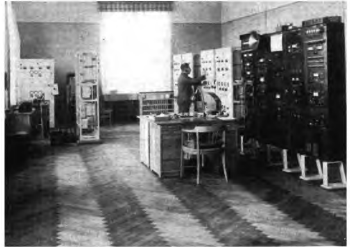
Der Verstärkerraum der Großempfangszentrale Beelitz. Der Mann im Hintergrund bedient soeben einen der Kurzwellenempfänger
