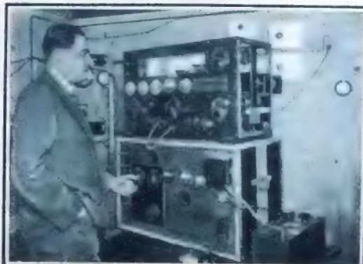
Die Wiener Kurzwellen-Sendeanlage, auch ein Bastlererzeugnis.
