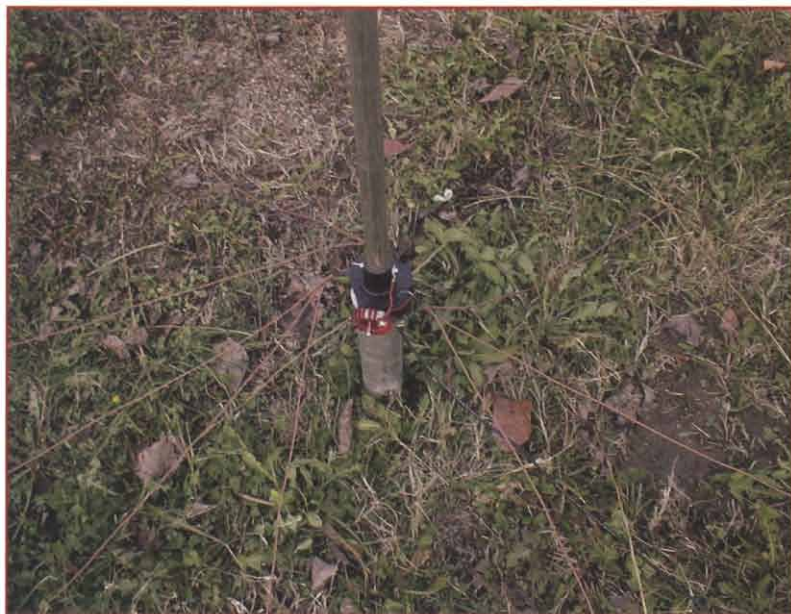
foto 4: base dell'antenna e radiali
