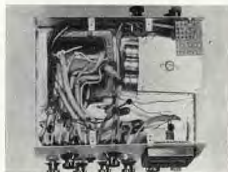
Vista dall'alto; sono visibili, in alto da sinistra, TR1, il commutatore C5 e T4 su radiatore. In basso, sotto i cavi, vi sono D1/D4 su radiatori, e, più in basso, i commutatori C2 e C4, gli shunt, avvolti su supporti di cartone e lo strumento.
