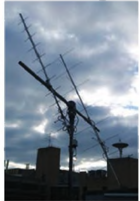
Sistema de antenas del Strand 1
