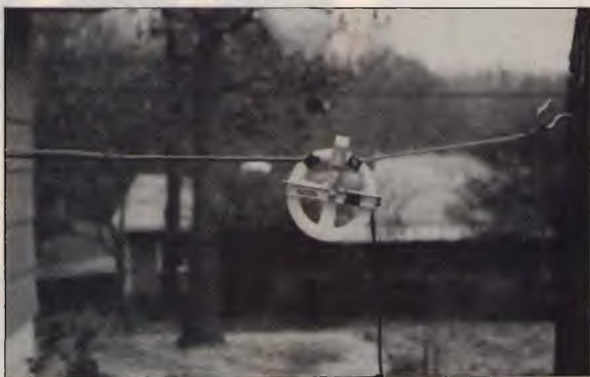
foto 1 Il sistema di sostegno dell'antenna coassiale.
