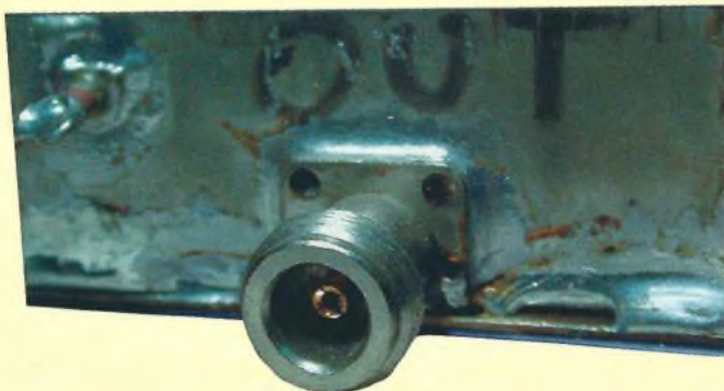
Fig. 18 - Les connecteurs sont intimement liés au châssis de l'amplificateur.
