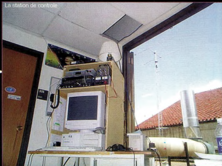
La station contrôle de CX.
