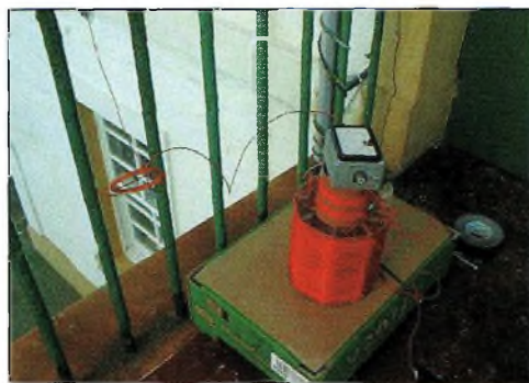
Le coupleur d'antenne en haut de l'escalier.
