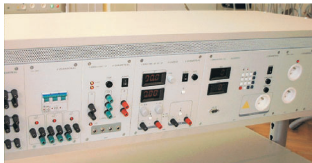
Obr. 3. Detailní pohled na vestavěné přístroje
