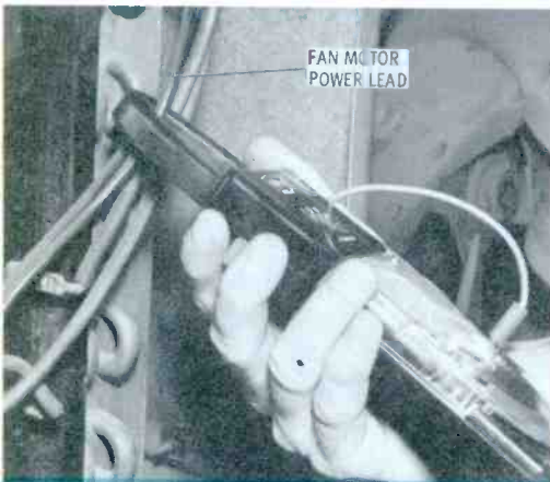
Fan and Motor
