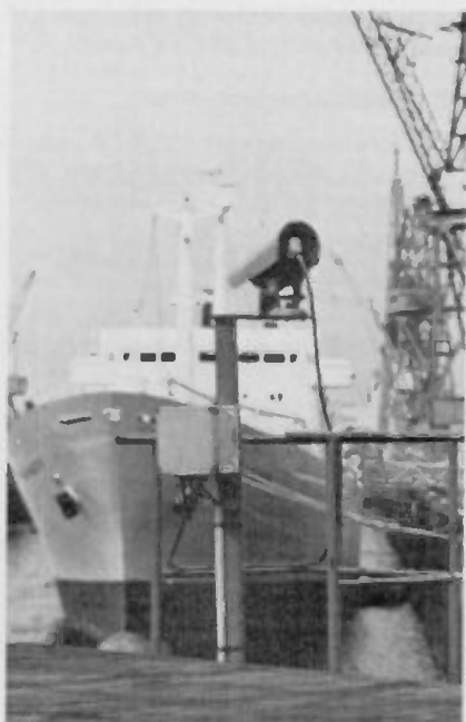
Bild 2 Feste Kamera für den Bereich des Vorhafens in der Grevenhofschleuse.
