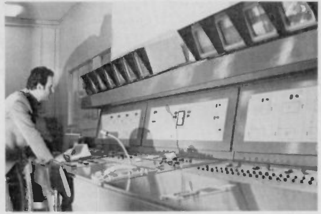
Bild 5 Leitstand Steinwerder mit Monitoren für die Kameras im und am alten Elbtunnel.
